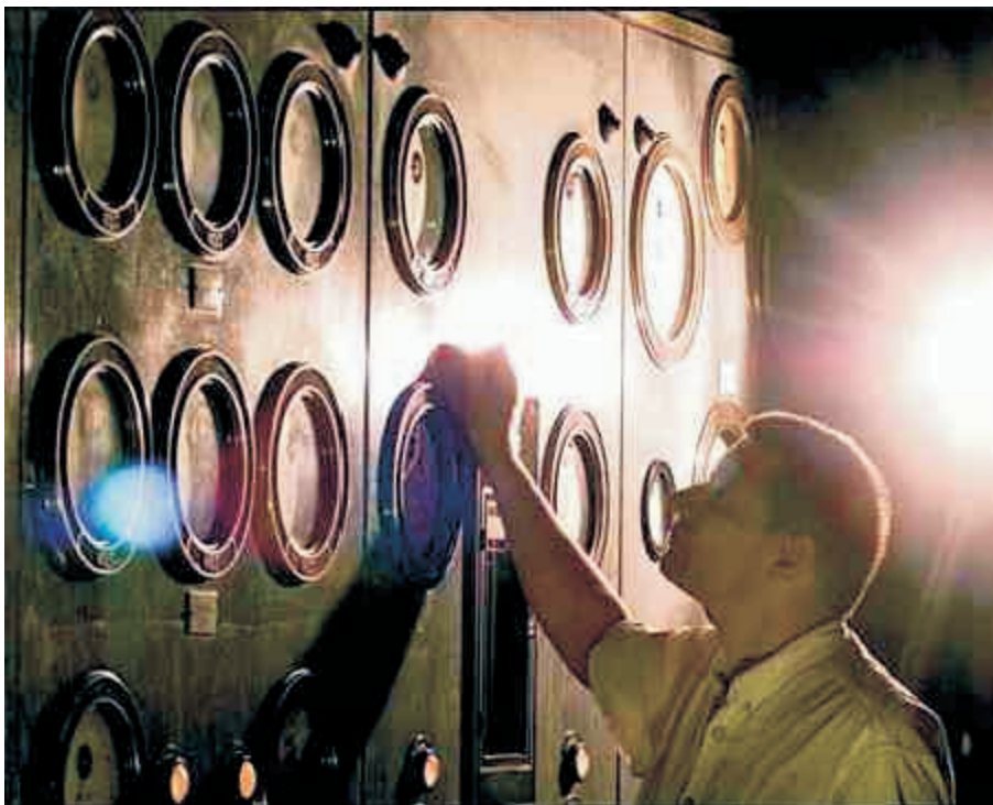
Schaltwarte des Kavernenkraftwerkes
